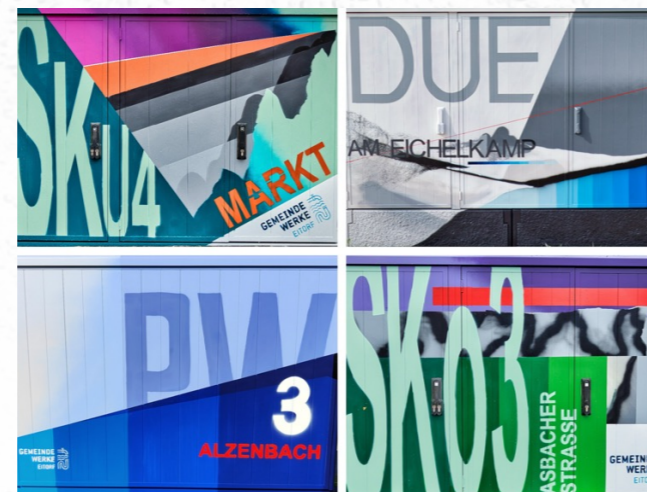
Auswahl der neu gestalteten Verteilerkästen in Eitorf (Quelle: eigene Aufnahme)
